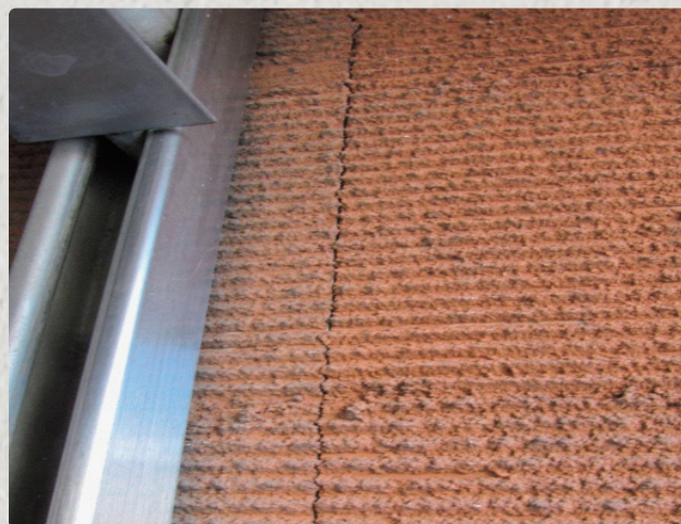
水性アクリル系櫛引仕上げ面、シャッター廻り。大きな動きによりクラックが発生。
