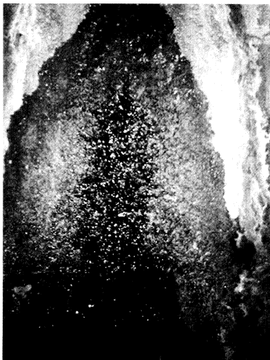
写真-3 漏水箇所(拡大)
