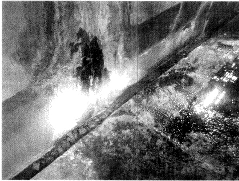
写真-2 漏水箇所付近。常時水溜りができている床
