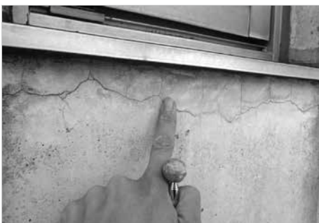
写真-1 外壁打放し面ひび割れ状況
