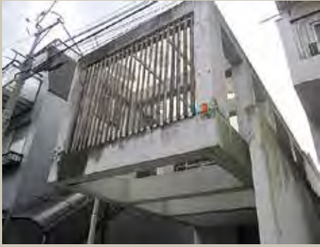
築10年経過のコンクリート打ち放し建造物。 黒カビと汚垂れによる汚れが顕著。
