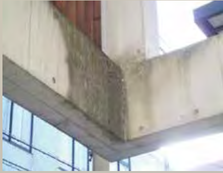
梁端部。コンクリートの表面に黒カビや苔が集中して発生している。
