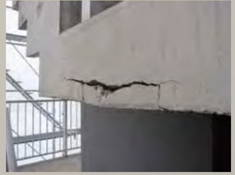
鉄筋が錆びて爆裂している様子。
