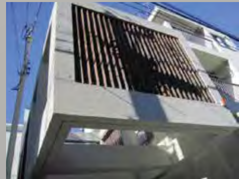
施工終了。美観がよみがえり、長期に美観を維持し、コンクリートを保護します。
