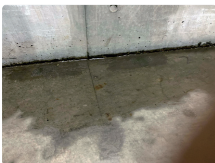
床と壁の塵際からの漏水
